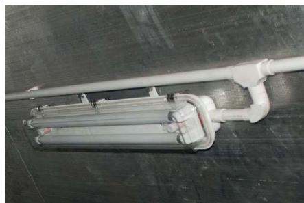
内部防爆灯照明
