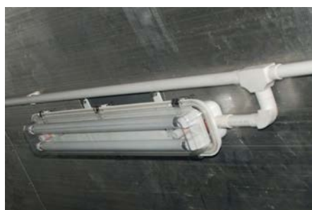
内部防爆灯照明
